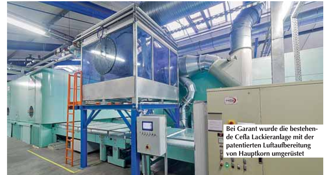
Nachgerüstete Luftaufbereitungstechnik von Hauptkorn in der Garant-Produktion nahe Erfurt, die eine signifikante Qualitätsverbesserung ermöglicht hat (Fotos: Benz + Heinig Fotografen)
