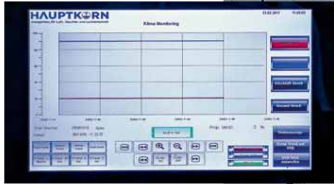
Bildschirmanzeige des Luftaufbereitungsteuerungsterminals
